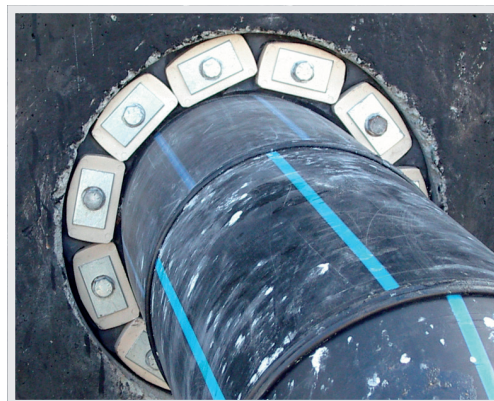
Водопроводные трубы диаметром 315 мм
